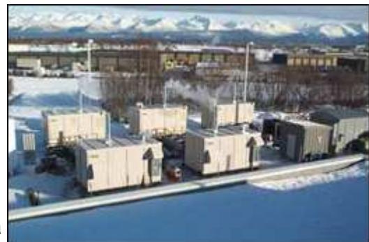
1MW-Anlage in Alaska (Bild: UTC Fuel Cells)
