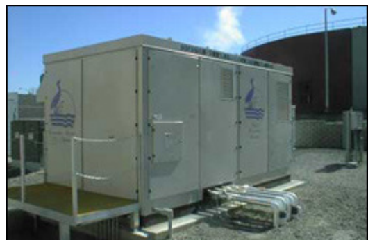
ONSI Blockheizkraftwerk von UTC Fuel Cells
